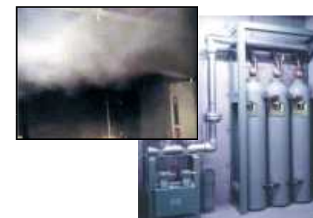
ガス消火設備 (コンピューター室等)
