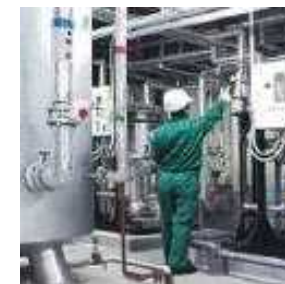
設備メンテナンス
