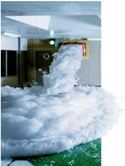
左写真:高発泡消火設備「パーフェックス」稼働事例
